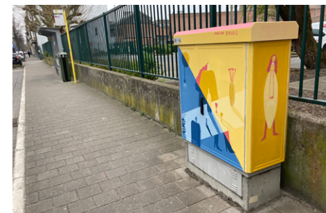
Kultivace elektrických rozvaděčů
